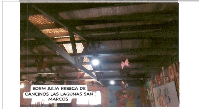
Foto 3: techo del aula en mal estado.
